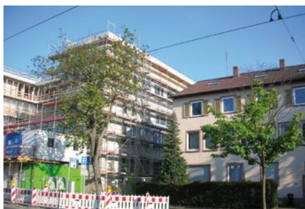
Abb.1: Neubau eines mehrgeschossigen Bürogebäudes mit Tiefgarage, Baugrube mit Verbau und Rückverankerung, angrenzende Bestandsgebäude errichtet in den 50iger Jahren.
