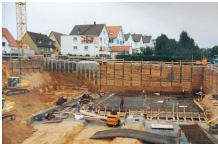
Abb.2: Gefährdungspotenzial für angrenzende Wohnhäuser durch Baugrubensicherung mit Berliner-Verbau, nicht überschrittene Betonbohrpfähle mit Rückverankerungen und Ausfachungen mit Spritzbeton.
