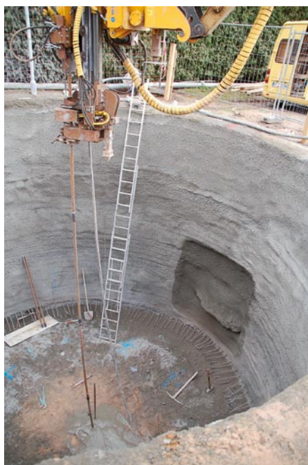
Abb.4: Gefährdungspotenzial durch die Herstellung von Start- und Zielgruben für Rohrvortriebsarbeiten, oft auch verbunden mit einer temporären Wasserhaltung.
