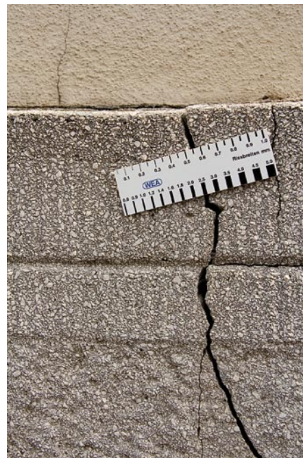
Abb.6: Bauteiltrennender Riss in einer Sockelbekleidung aus Betonwerkstein.
